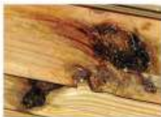
Гнилой По состоянию
