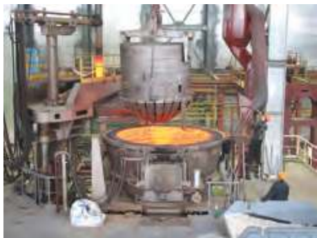
Агульны выгляд электрадуговой печи
